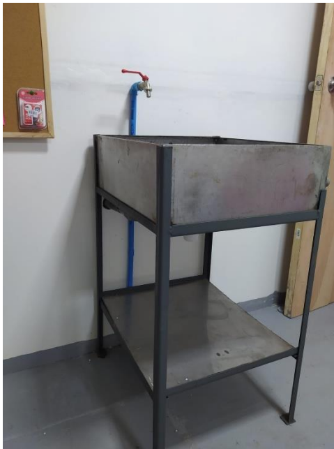
Figura 5. Llave de agua potable. Fuente: Elaboración propia.
