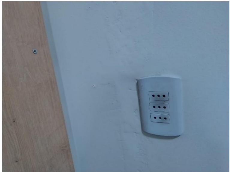
Figura 8. Punto de conexión de electricidad. Fuente: Elaboración propia
