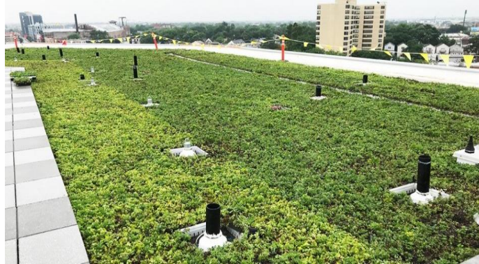
Figura 5. Techos verdes. Fuente: Verdeac (2021). Riego eficiente en techos vegetales con sedums
