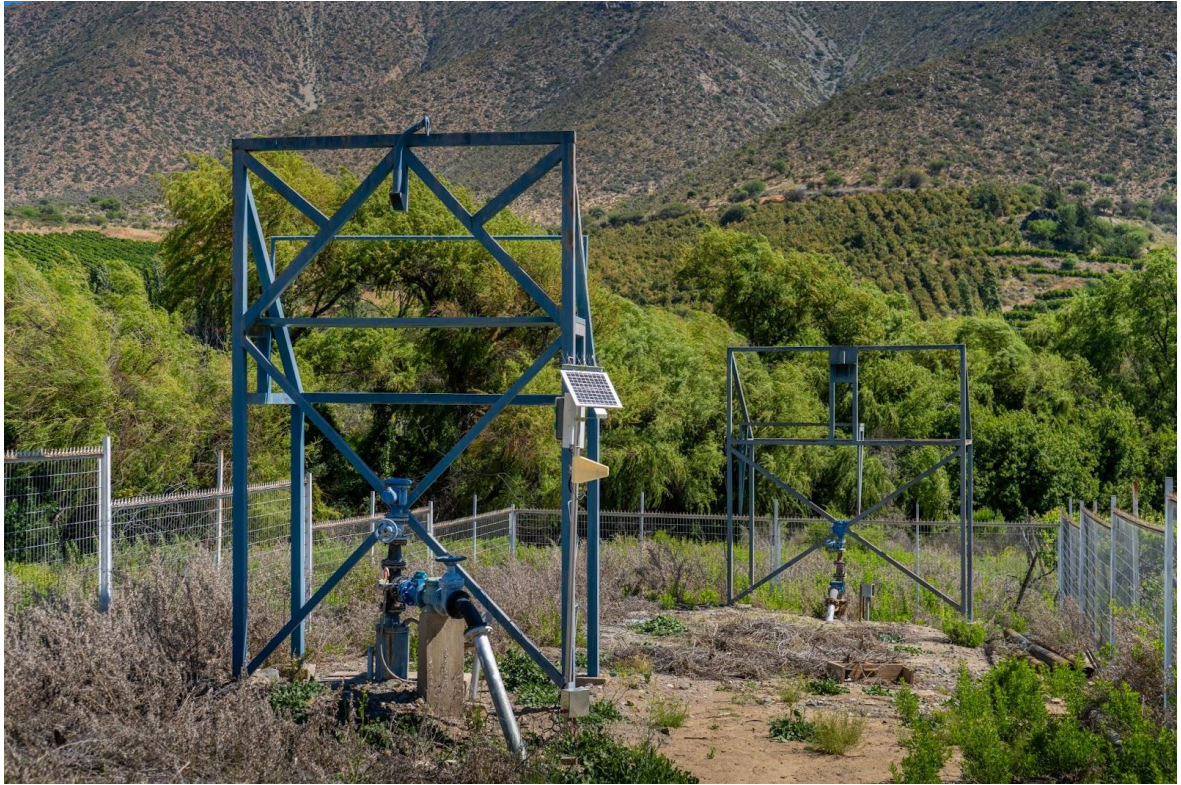
Fig. 60 Pozos de agua potable de Cerrillos de Rapel, 2024.
